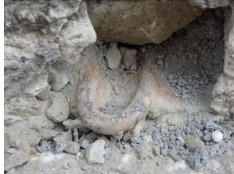
Fot. Skorodowana szpilka
